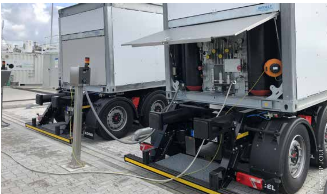
Mobile Wasserstoffspeicher in Bosbüll, Nordfriesland von GP JOULE
